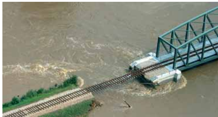
Abb. 2-2: Zerstörter Eisenbahndamm im Kemptal, NÖ
