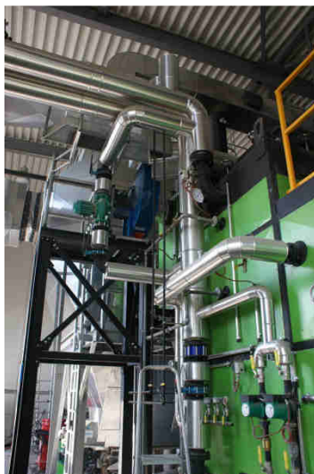
Feuerung, Kessel und Hydraulik
