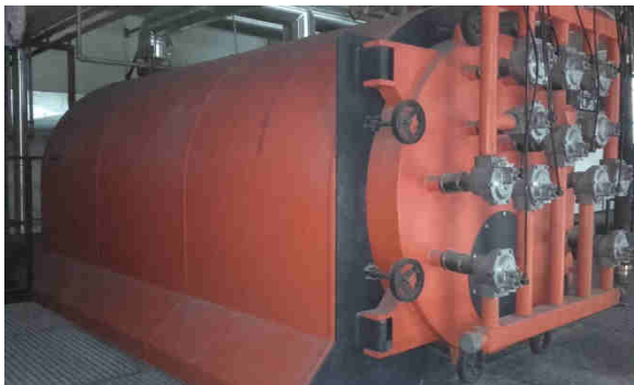
Kessel mit Abreinigungssystem
