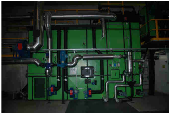
Feuerung und Kessel
