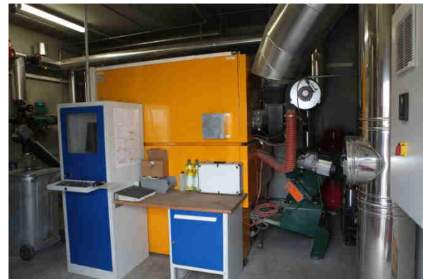
Feuerung und Kessel mit Schaltwarte
