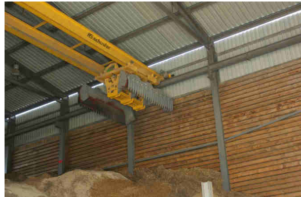
Kran zur Brennstoffbeschickung
