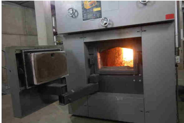
Blick in die Feuerung
