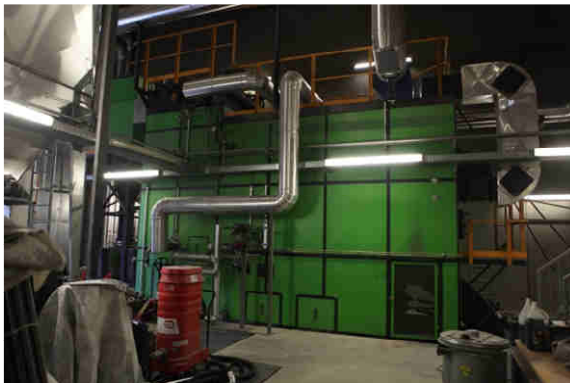
Seitenansicht Feuerung und Kessel
