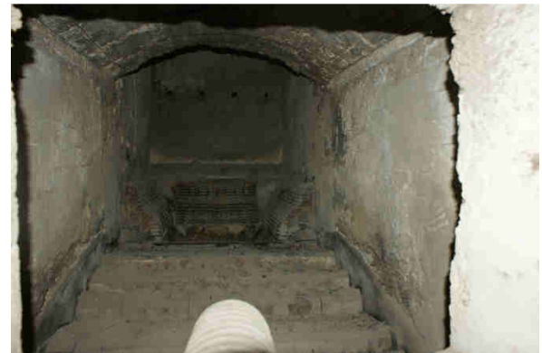
Rost und Brennkammer
