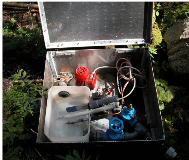
Truhe mit Turbine zur Stromversorgung und Erfassung von Leitfähigkeit, Temperatur und Trübung (Gollinger Wasserfall, Salzburg, © HD-Salzburg)
