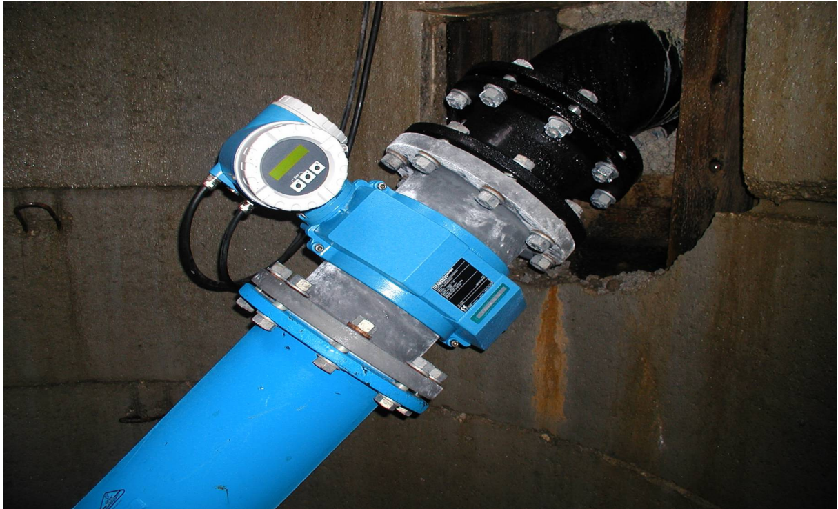
Messstelle an einer gefassten Quelle , Messung des Durchflusses am Ablaufrohr mittels Magnetisch-induktiver Durchflussmessung – MID (Alfutzquelle, Tirol, © HD-Tirol)
