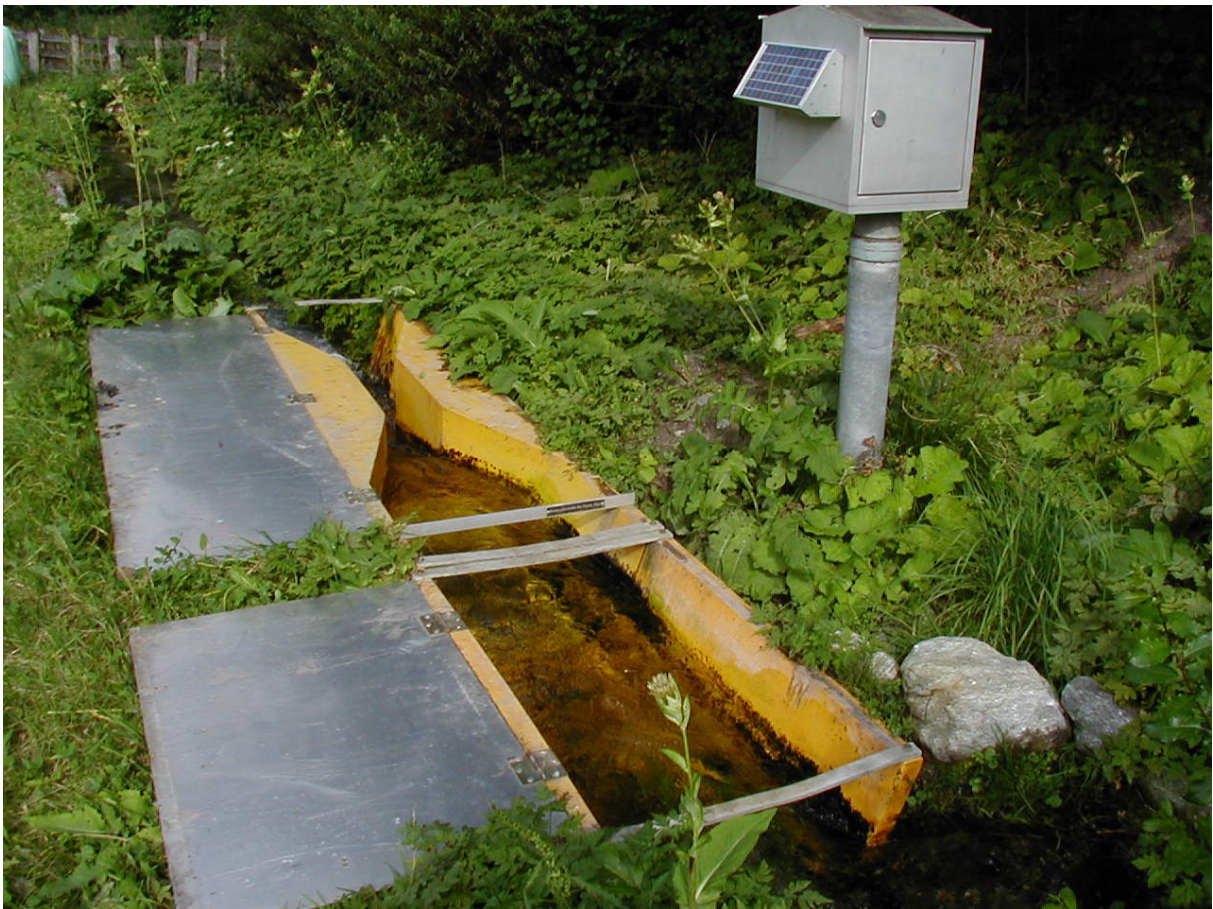
Messstelle mit Venturigerinne , dieses verfügt über eine Abdeckung zur Verhinderung von Algenaufwuchs, Datensammler in kleinem Schaltschrank, auf dessen linker Außenseite ist ein Solarpaneel montiert (Brunauquelle, Tirol, © HD-Tirol)
