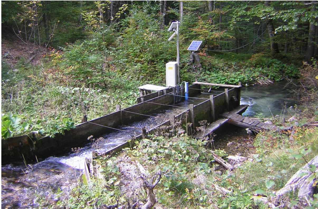
Messstelle mit langer Beruhigungsstrecke und Drucksonde in einem Hüllrohr, Energieversorgung mittels Solarpaneelen (Hainschbauernquelle, Kärnten, © Jutta Eybl)
