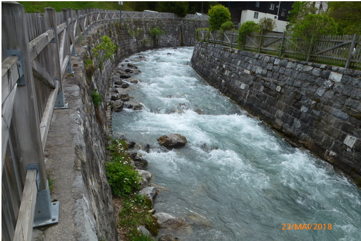
Abb. 1: Bestehende Regulierungsverbauung des Zürsbaches im Ort Lech. Die Oberkante des Fundamentes der auf der Abbildung linken Ufermauer ist gut zu erkennen.
