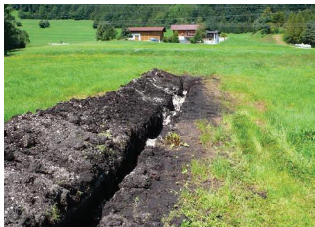
Intensivgrünland auf Torfböden mit Torfaushub für Drainage. © C. Geitner
