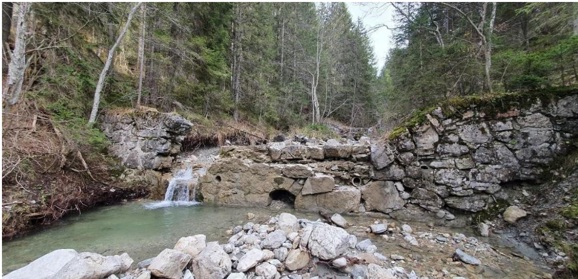
Abbildung 1: Stark beschädigte Wildbachsperre im Oberlauf des Logbachs
