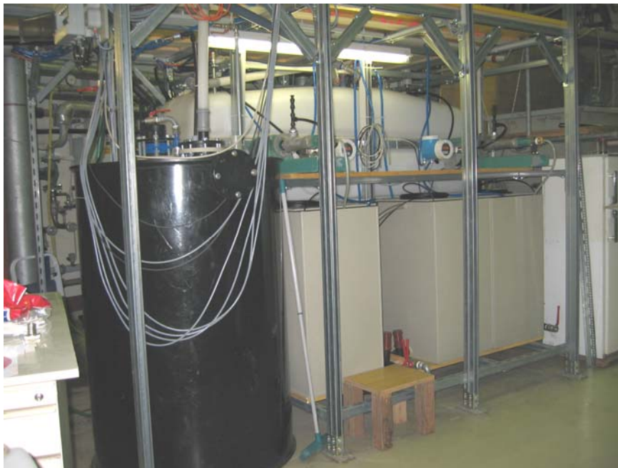
Abbildung 4 Die untere Ebene der Versuchsanlage (schwarzer runder Vorlagetank; viereckige Ablauftanks; in Hintergrund das weiße Belebungsbecken).
