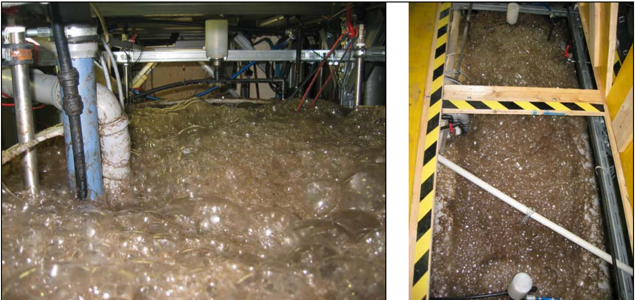
Abbildung 12 Starkes Schäumen im Belebungsbecken während der Einfahrphase Anfang Jänner 2009.
