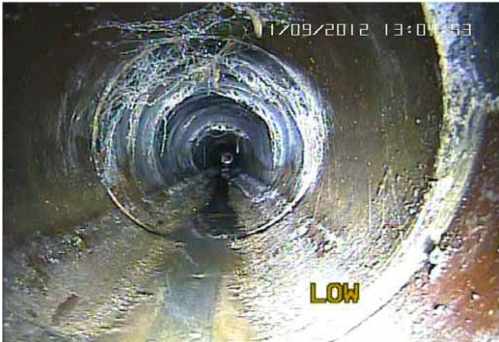
Abbildung 144 - ausreichender Selbstreinigungseffekt eines Kanalabschnittes
