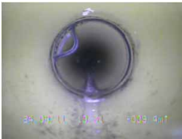
Abbildung 65 - BAI-A-B einragendes Dichtungsmaterial, Dichtring, hängend, nicht gebrochen oberh. Mitte; Kreisprofil DN 200 - Glasfaserverstärkter Kunststoff; Schiebekamera
