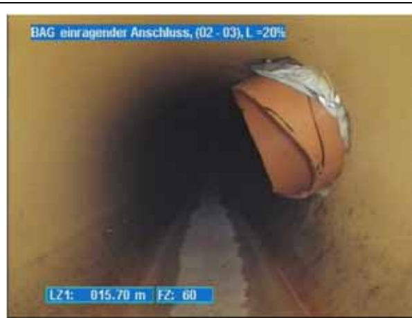
Abbildung 69 - BAG einragender Anschluss; L=17%; Kreisprofil DN 260 - Glasfaserverstärkter Kunststoff; TV-Kamera 1
