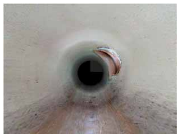
Abbildung 74 - BAG einragender Anschluss; L=17%; Kreisprofil DN 260 - Glasfaserverstärkter Kunststoff; Scan System 1
