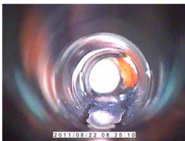
Abbildung 56 - BAG einragender Anschluss; L=17%; Kreisprofil DN 260 - Glasfaserverstärkter Kunststoff; elektr. Spiegel 1
