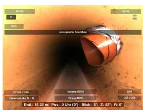
Abbildung 70 - BAG einragender Anschluss; L=17%; Kreisprofil DN 260 - Glasfaserverstärkter Kunststoff; Scan System 2
