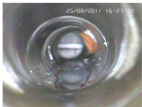
Abbildung 55 - BAG einragender Anschluss; L=17%; Kreisprofil DN 260 - Glasfaserverstärkter Kunststoff; elektr. Spiegel 2
