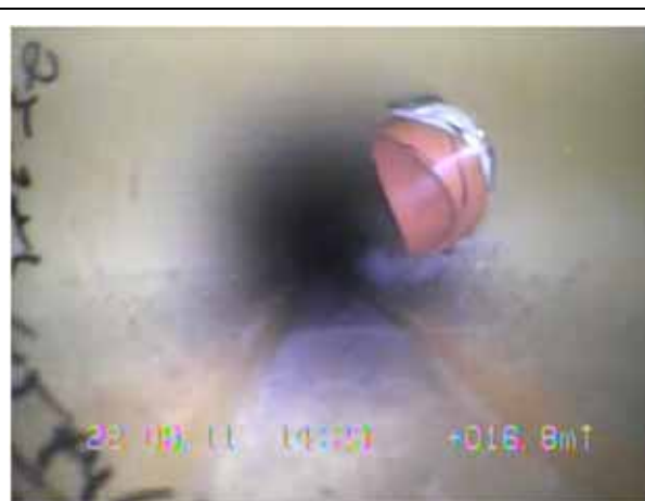
Abbildung 71 - BAG einragender Anschluss; L=17%; Kreisprofil DN 260 - Glasfaserverstärkter Kunststoff; Schiebekamera
