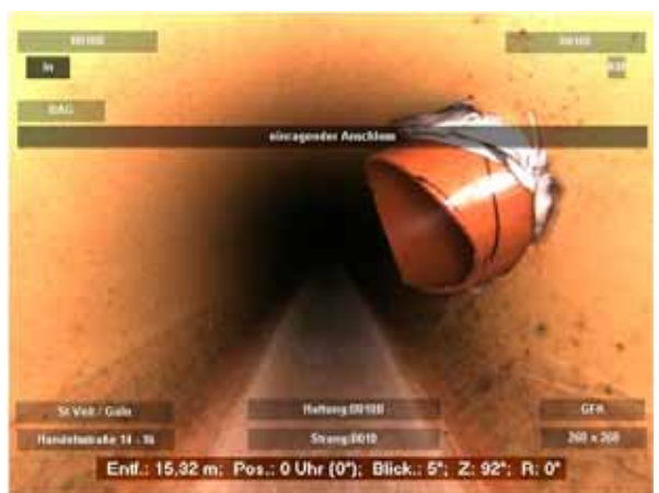
Abbildung 53 - BAG einragender Anschluss; L=17%; DN 260 - Glasfaserverstärkter Kunststoff; Scan System 2
