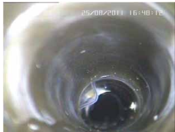
Abbildung 66 - BAI-A-B einragendes Dichtungsmaterial, Dichtring, hängend, nicht gebrochen oberh. Mitte; Kreisprofil DN 200 - Glasfaserverstärkter Kunststoff; elektr. Spiegel 2
