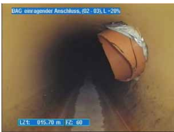
Abbildung 52 - BAG einragender Anschluss; L=17%; DN 260 - Glasfaserverstärkter Kunststoff; TV-Kamera 1
