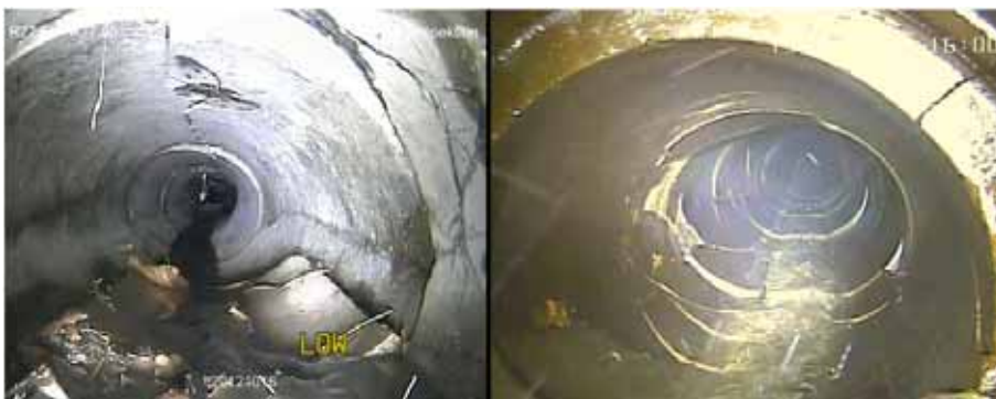
Abbildung 85 - Haltungen mit sofortigem Sanierungsbedarf
