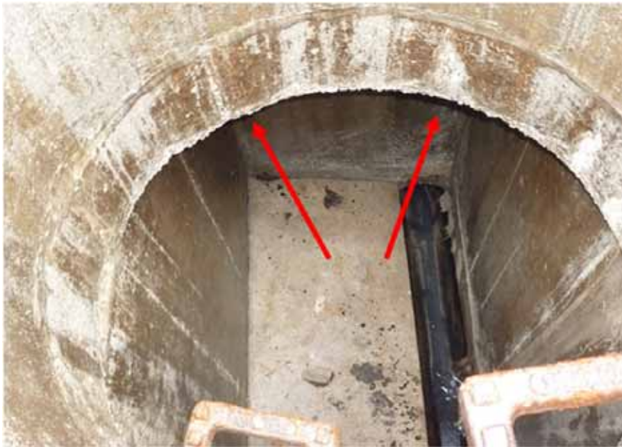
Abbildung 200 - Schwierigkeit der Zustandserkennung bei Ortbetonschächten
