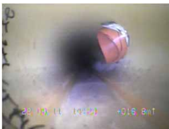
Abbildung 54 - BAG einragender Anschluss; L=17%; Kreisprofil DN 260 - Glasfaserverstärkter Kunststoff; Schiebekamera
