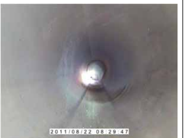
Abbildung 45 - BAF-A-E Oberflächenschaden, erhöhte Rauheit, nicht eindeutig feststellbar; Kreisprofil DN 200 - Duktiles Gusseisen; elektr. Spiegel 1
