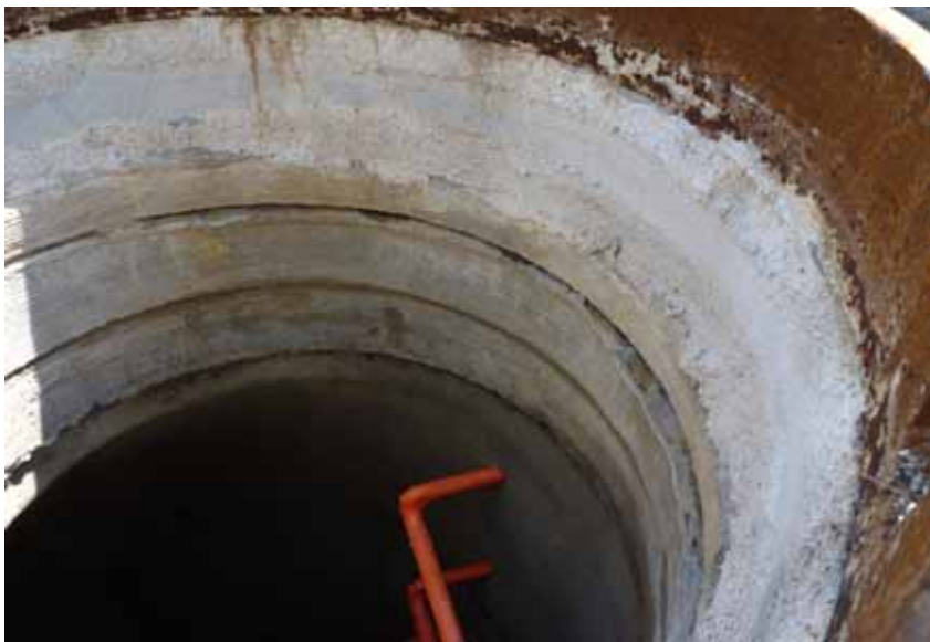
Abbildung 199 - Oberflächenschäden bei den Auflageringen
