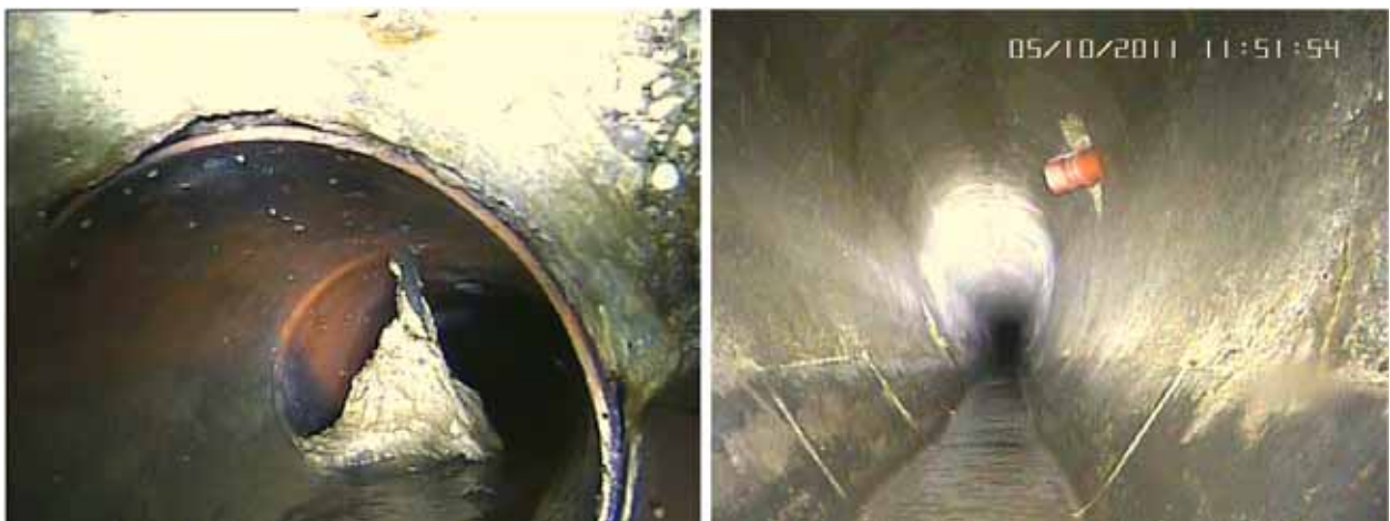
Abbildung 91 - einragender Dichtring (links) / einragender Hausanschluss mit defekter Rohrwandung (rechts)
