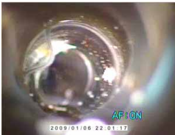
Abbildung 67 - BAI-A-B einragendes Dichtungsmaterial, Dichtring, hängend, nicht gebrochen oberh. Mitte; Kreisprofil DN 200 - Glasfaserverstärkter Kunststoff; elektr. Spiegel 1
