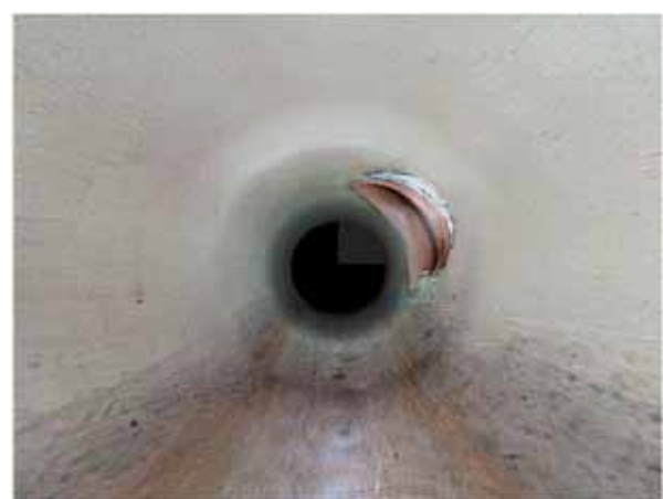
Abbildung 57 - BAG einragender Anschluss; L=17%; Kreisprofil DN 260 - Glasfaserverstärkter Kunststoff; Scan System 1
