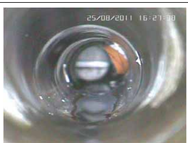
Abbildung 72 - BAG einragender Anschluss; L=17%; Kreisprofil DN 260 - Glasfaserverstärkter Kunststoff; elektr. Spiegel 2
