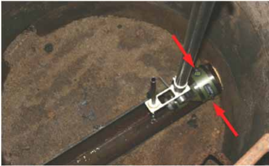
Abbildung 96 - zu geringer Sohlen-Rohrdurchmesser im Schacht
