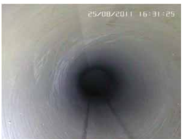
Abbildung 44 - BAF-A-E Oberflächenschaden, erhöhte Rauheit, nicht eindeutig feststellbar; Kreisprofil DN 200 - Duktiles Gusseisen; elektr. Spiegel 2
