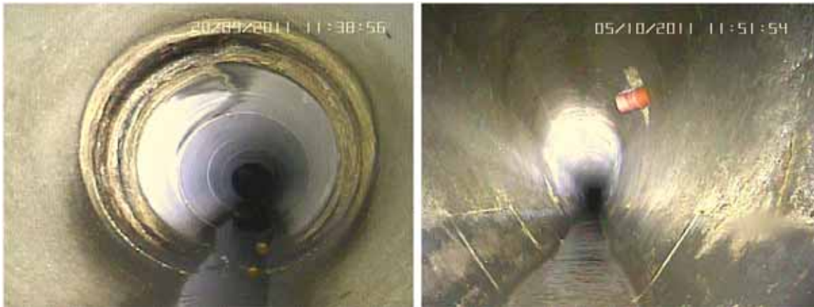
Abbildung 81 - Beispiele zur baulichen Zustandserfassung (Plihal et al., 2014b)
