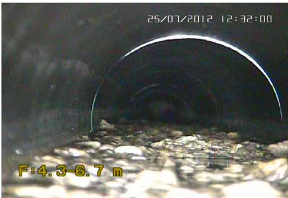
Abbildung 145 - erhöhtes Ablagerungsaufkommen aufgrund eines baulichen und/oder betrieblichen Mangels
