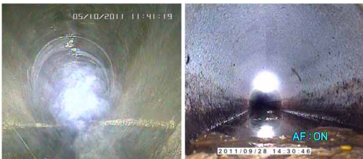
Abbildung 100 - Wasserdampf (linkes Bild) bzw. zu hoher Wasserstand (rechtes Bild) als betriebliche Hindernisse bei der Zustandserfassung
