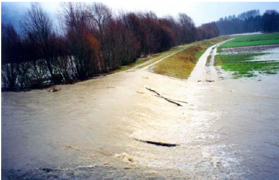
Abbildung 2-17: Überströmstrecke der Gail während des Hochwassers 2002
