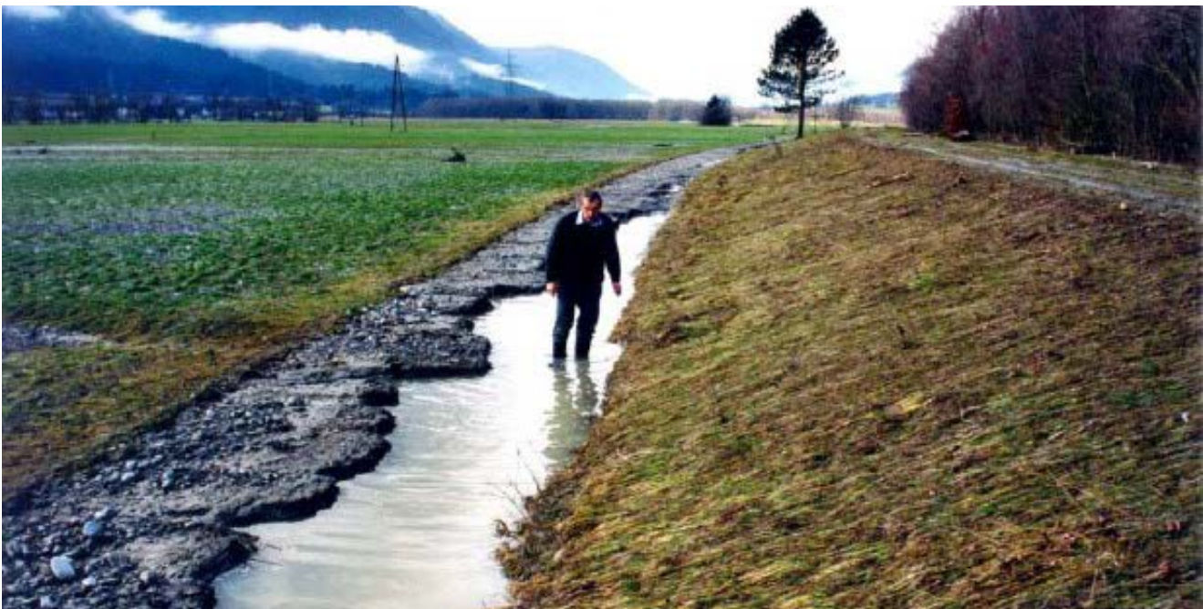
Abbildung 2-19: Überströmstrecke der Gail, Erosionsschäden am Begleitweg nach dem Hochwasser 2002
