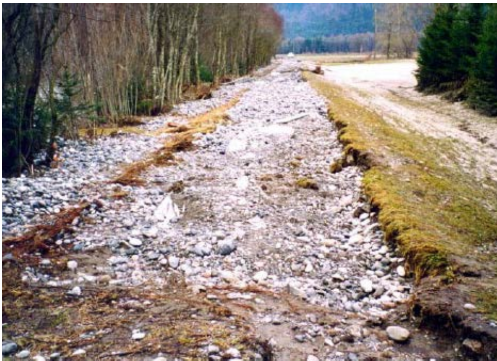
Abbildung 2-21: Überströmstrecke der Gail nach der Überströmung 2002 Erosionsschäden am Fahrweg auf der Dammkrone
