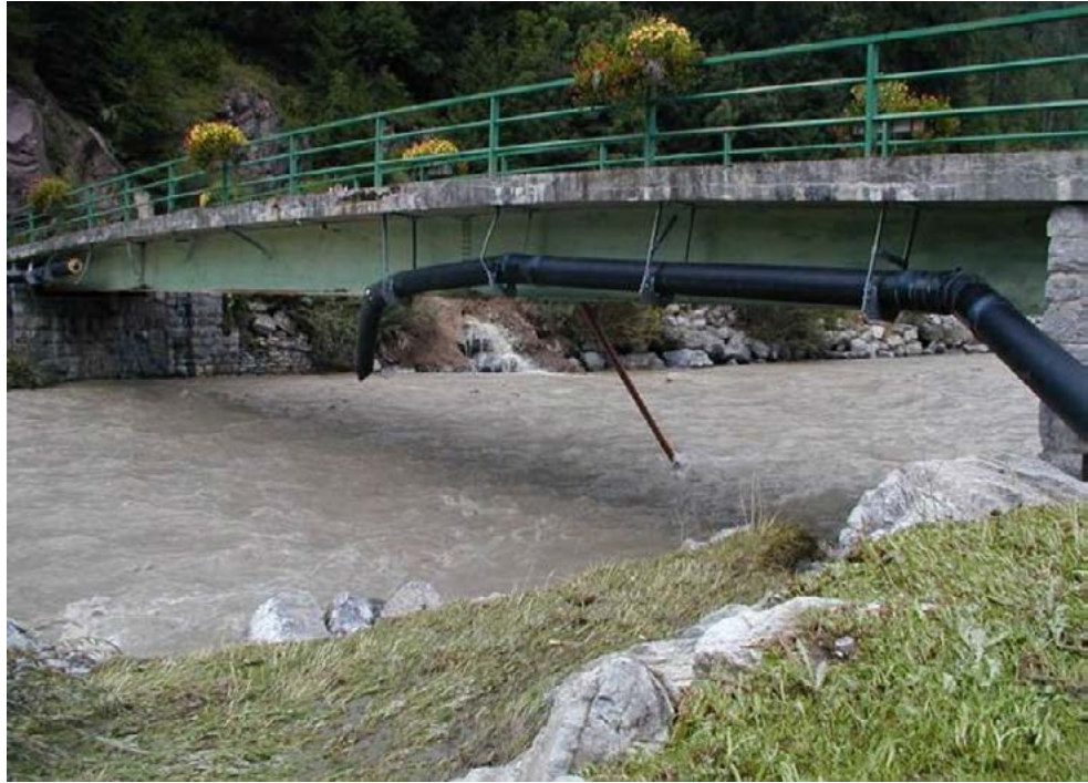
Abbildung 1-14: Brücke mit beschädigter Rohrleitung nach dem Hochwasser
