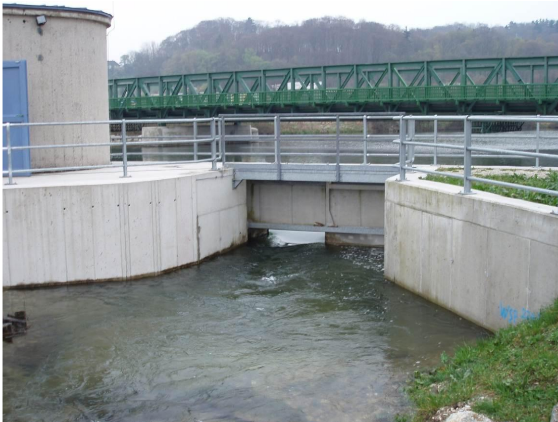
Abbildung 33: Reduktion der Öffnungsbreite durch Horizontalschieber zur Dotationssteuerung am Ausstieg der FAH am KW Kimmelbach
