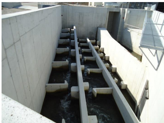
Vertical Slot Fischpass beim Kraftwerk Greinsfurth an der Ybbs, © BMLFUW/DI Verena Ressel
