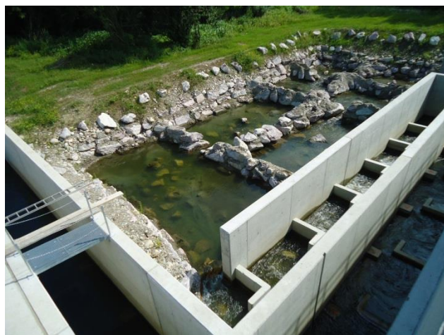
Kombinierter Becken- und Vertical Slot Pass beim Kraftwerk Niklasdorf an der Mur, © BMLFUW/DI Verena Ressel
