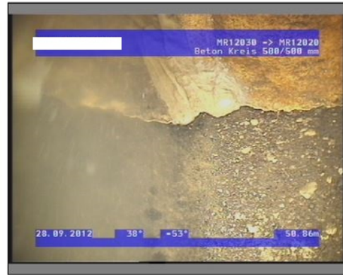
51,11m, Schadhafte Innenauskleidung, Fläche: 5cm 2 , von 4 bis 6 Uhr / Ablösung Auskleidung
