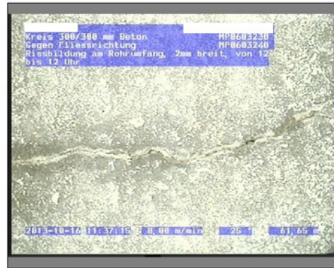
61,65m, Rissbildung am Rohrumfang, 2mm breit, von 12 bis 12 Uhr
