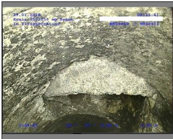
1,39m, Einragender Anschluss, einrag. Länge als Prozentanteil des Durchmessers: 15 %, bei 2 Uhr
