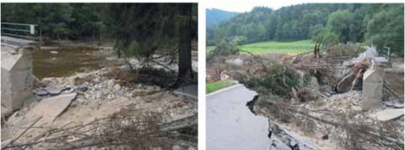
Abbildung 5-19: Bachausbrüche am Tullbach/Stmk. (links), und am Kamp/NÖ (rechts). (© WLV Bruck (linkes Foto), H.P. Rauch (rechtes Foto)).
