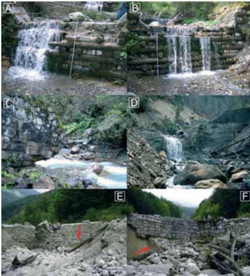
Abbildung 7-9: Aufweitung der Abflusssektion und Abtrag des Sperrenkörpers: (A): Abtrag des Sperrenkörpers einer Holzkastensperre; (B): Ausweitung der Abflusssektion durch fehlende Kronsteine und obersten Holzbohlen; (C): vollständig abgetragene Abflusssektion einer Steinsperre; (D): Aufweitung der Abflusssektion einer Betonsperre; (E)+(F): Abtrag aufgrund eines hydraulischen Grundbruchs und einer Unterströmung. (© Foto D: IAN).
