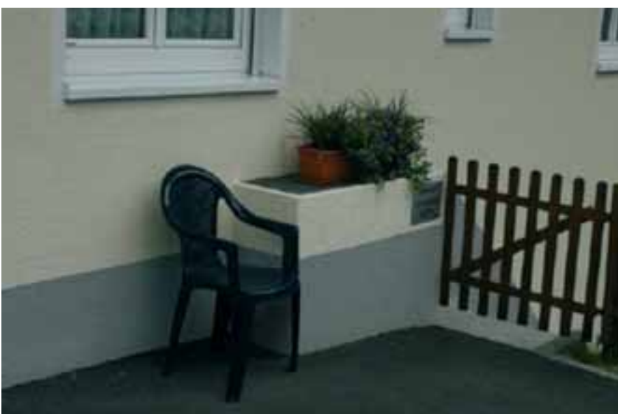
Abbildung 7-15: Verhinderung des Eintritts von Wasser und Feststoffen durch einen über das Flutniveau gezogenen Kellerlichtschacht aus Beton, der druckwasserdicht mit der Wand verbunden und nach unten geschlossen wurde. (Holub, 2005).
