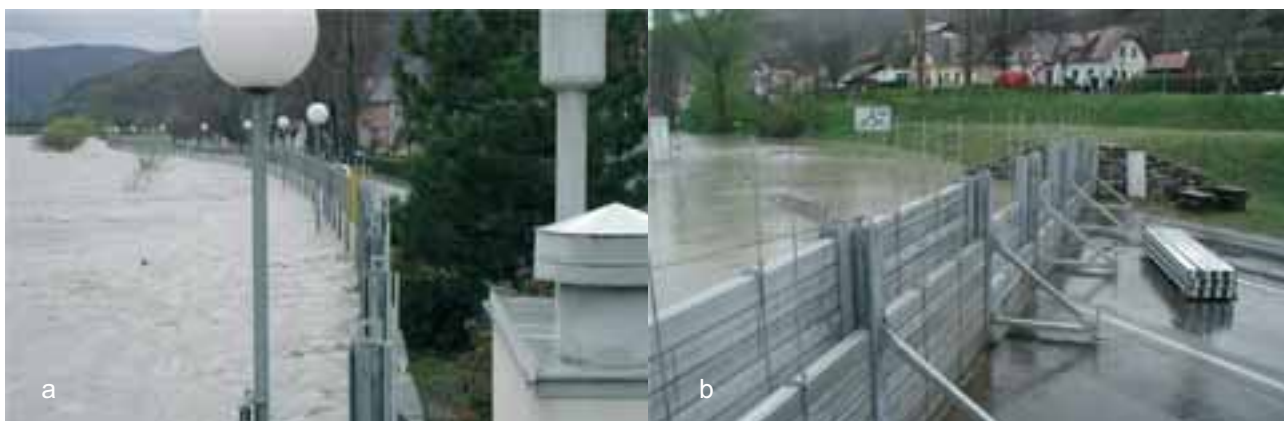
Abbildung 7-20: Mobile Hochwasserschutzsysteme (Dambalkensystem) – Hochwasserschutz Krems-Stein (Quelle: Hydro Ingenieure).
