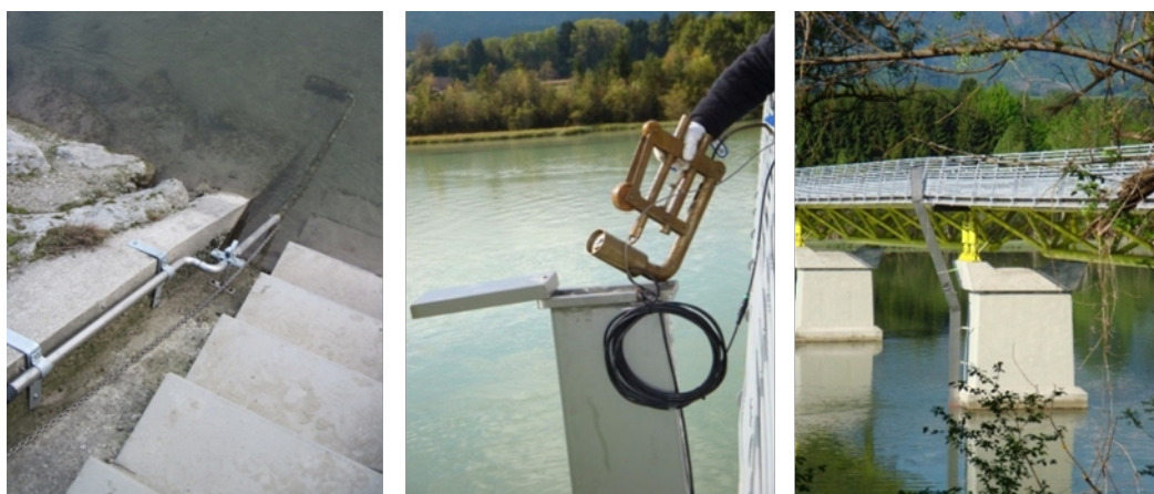
Abbildung 5: links: Klappkonstruktion für Solitax ts-line; Dt. Brodersdorf/Leitha (Foto: Krammer) Mitte und rechts: Einbau an Brückenpfeilern mit Schienensystem zur einfachen Zugänglichkeit zu Wartungszwecken und bei Hochwasser; Projektmessstelle an der Drau (Fotos Schabus)
