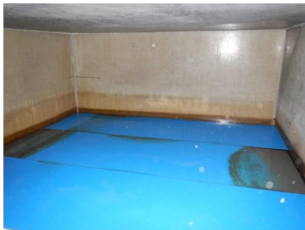
Abbildung 3: Schwimmende Kunststoffdecke im Hochbehälter (19.02.2014)
