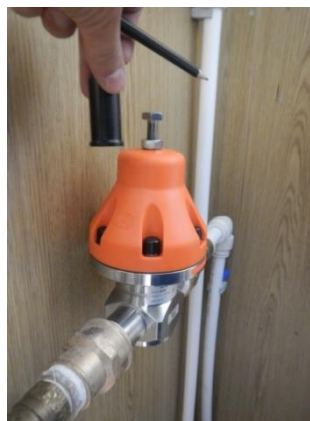
Abbildung 11: Druckhalteventil im Ablauf der UV-Desinfektionsanlage
