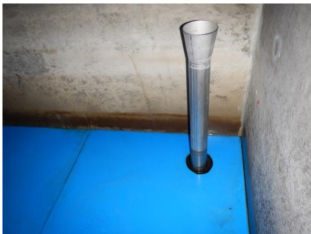
Abbildung 2: Schwimmende Kunststoffdecke im Hochbehälter (06.02.2014)
