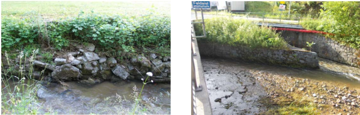
Abbildung 7-98: Links: Beschädigte Ufermauer und Sohlenerosion an der Feldaist (Quelle: GWB Linz); Rechts: Ablagerungen beim Zubringer in die Feldaist (Quelle: GWB Linz)
