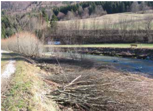
Auch dichter Aufwuchs aus Spreitlagen oder Faschinen führt zu Profilverengungen und zur Gefahr von Ausuferungen im Oberlauf.
