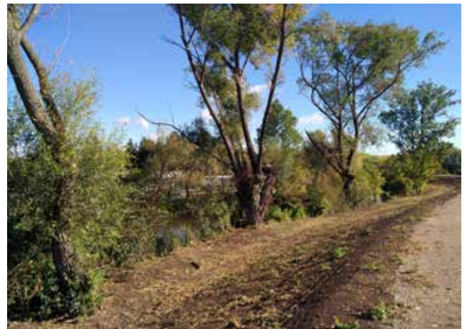
Verlust der Standfestigkeit durch falschen Schnitt. Werden Gehölze zu spät (Kopfweiden) oder nur landseitig zurück geschnitten, verlieren sie langfristig ihre Standfestigkeit.
