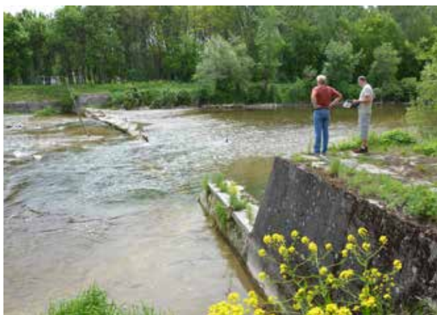
Beschädigungen an der Sohlstufe 3 an der Traisen.
