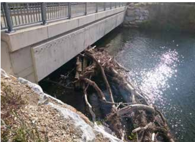
Verklausung an einem Drosselbauwerk.
