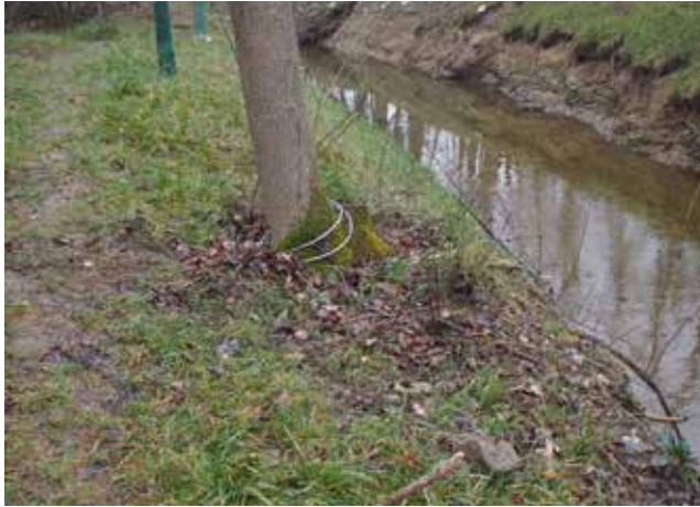
Mit Stahlseil und Erdanker befestigtes, erosionsgefährdetes Ufergehölz.
