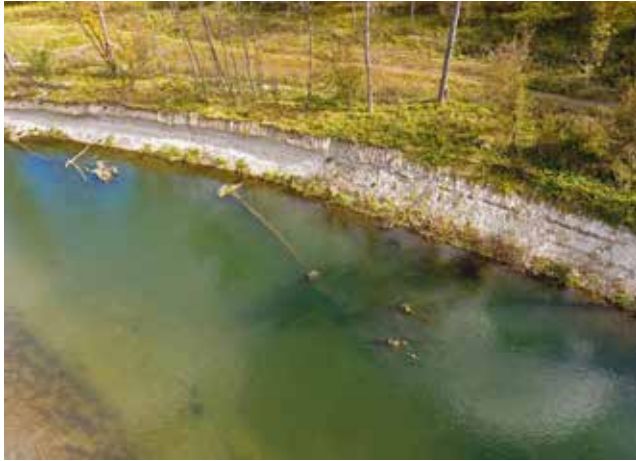
Uferanriss im Mündungsbereich der Traisen. Mögliche Erosionsflächen wurden dem Grundeigentümer abgelöst, um Konflikte zu reduzieren. © Pock
