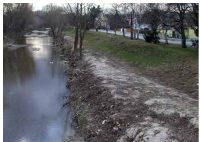
Ortsstrecke an der Leitha. Unter eingeschränkten räumlichen Freiheitsgraden stellen regelmäßig auf den Stock gesetzte Gewässerabschnitte kostenintensive Dauerbaustellen dar.
