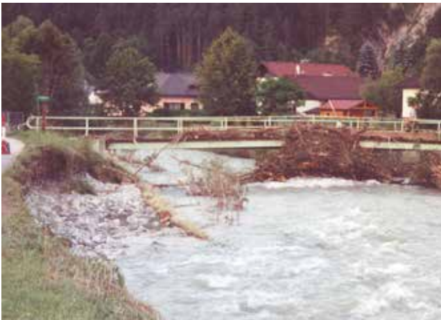
Verklauung einer Brücke bei Hochwasser an der Türritzer Traisen im Jahr 1997. © NÖ Landesregierung
