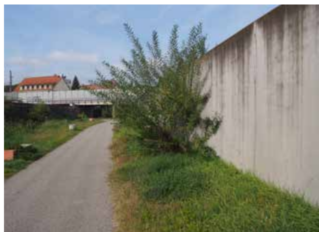
Hochwasserschutzmauer. Wasserseitiger Bewuchs ist zu entfernen.
