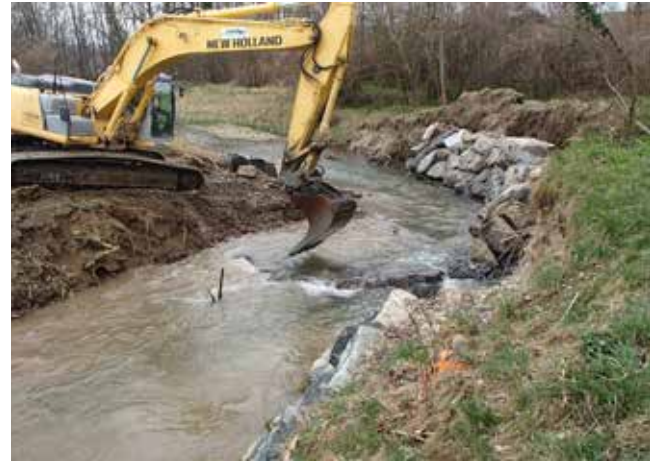
Blockwurfsicherung nach Uferanriss.
