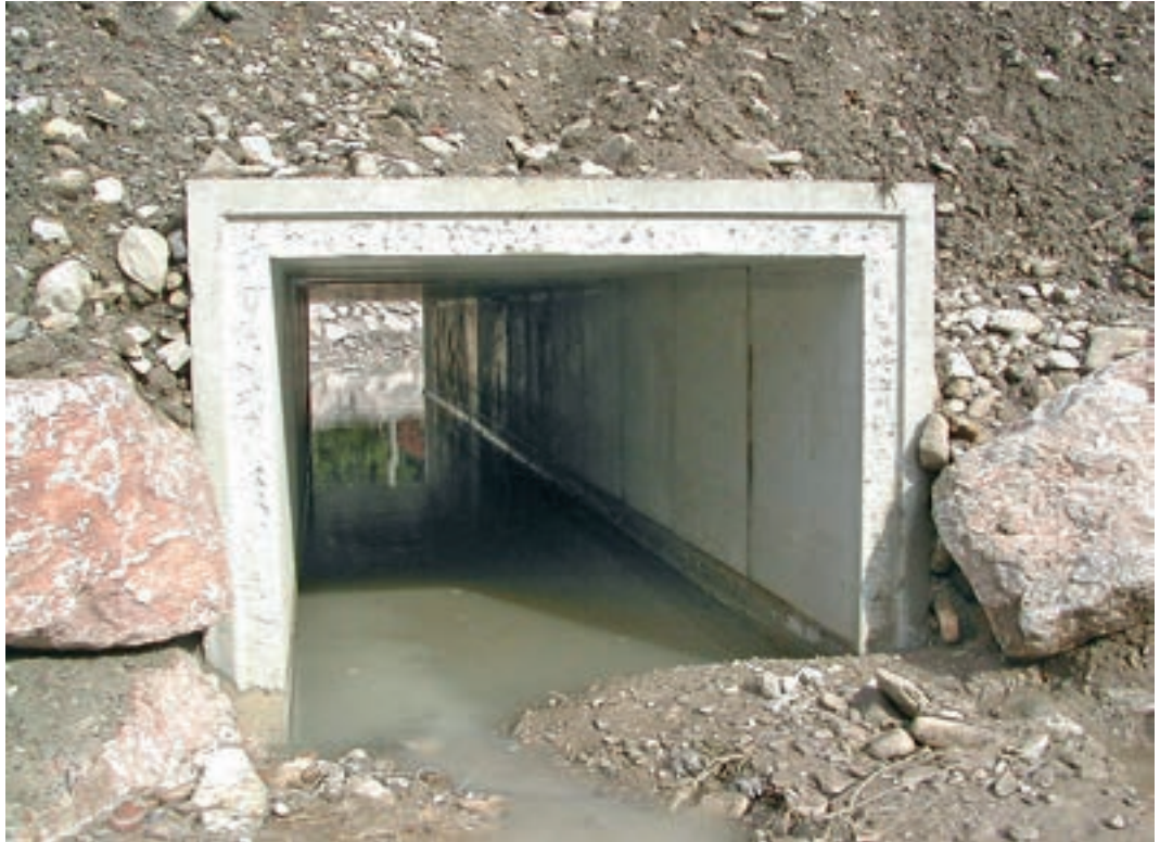
Foto 4.53: Mit Kastendurchlässen kann ein ausreichend großes Querprofil hergestellt werden. (© ezb)
