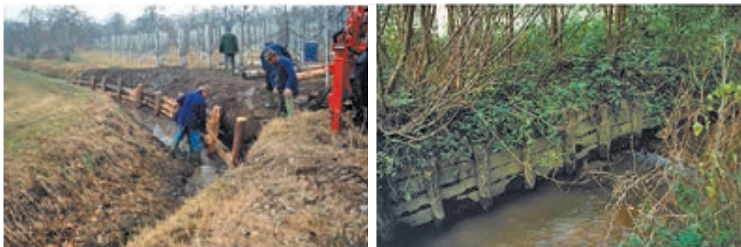
Foto 6.20–6.21: Links – Rangenverbau im Bau, Weißenbach/Südtirol, rechts – Rangenverbau mit Holzbrettern (Schlachtenwand), Lugnitz. (© Florineth)
