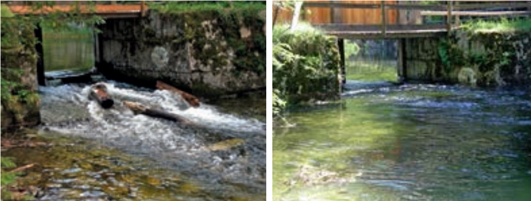
Fotos 4.55–4.56: Seeausrinn Toplitzbach/Stmk.: Um die Seeklause fischpassierbar zu machen, wurde entschieden, nicht die Klause selbst zu adaptieren, sondern den Unterwasserspiegel durch Errichtung einer fischpassierbaren Rampe aufzuheben. (© ezb, TB Zauner)
