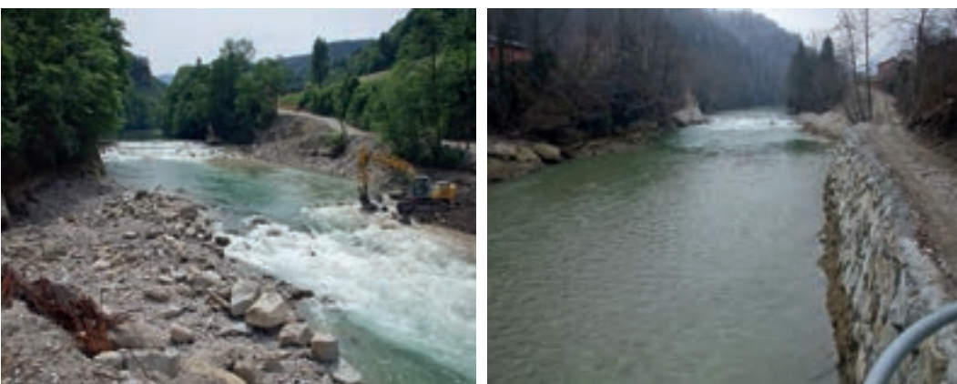
Fotos 7.10–7.11: Steinschwelle zur Stauraumverlandung im Stauraum des KW Schütt an der Ybbs/NÖ 200 Meter flussauf des Wehres, Bauzustand abgesenkter Stau. (© ezb)
