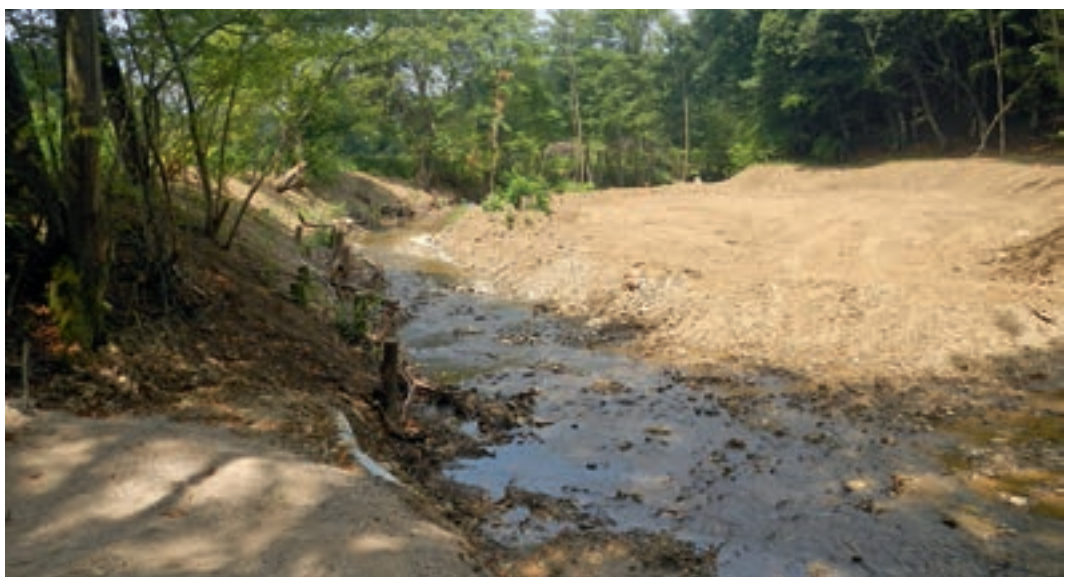
Foto 10.1: Geschiebepufferbereich am Sattelbach/NÖ unmittelbar nach Bauausführung. Durch Aufweitung des Hochwasserabflussprofils lagern sich hier Geschiebeeinstöße nach Extremereignissen gezielt ab und können bei kleineren Hochwässern sukzessive flussab transportiert werden. Infolge der großen Abflusskapazität können hier Auflandungen zugelassen werden, ohne den Hochwasserschutz benachbarter Flächen zu gefährden. (© ezb)
