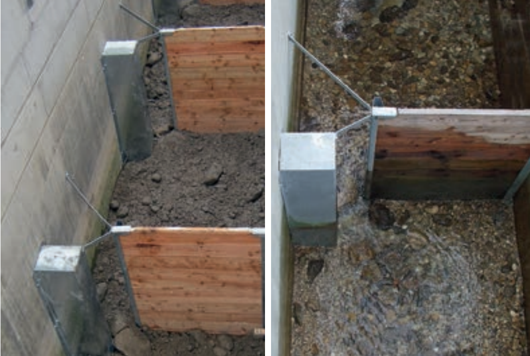
Fotos 4.37–4.38: Sohlausformung Vertical-Slot-Pass an der Ybbs beim KW Schütt/NÖ. (© ezb)
