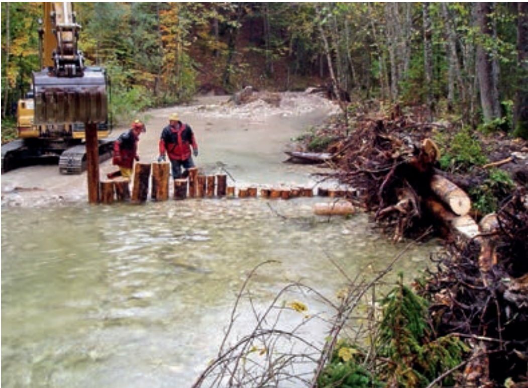
Foto 10.4: Bei Schwellen aus Holzpiloten ist auf eine fischpassierbare Niederwasserrinne mit rauer Sohle zu achten. (© ezb, TB Zauner)
