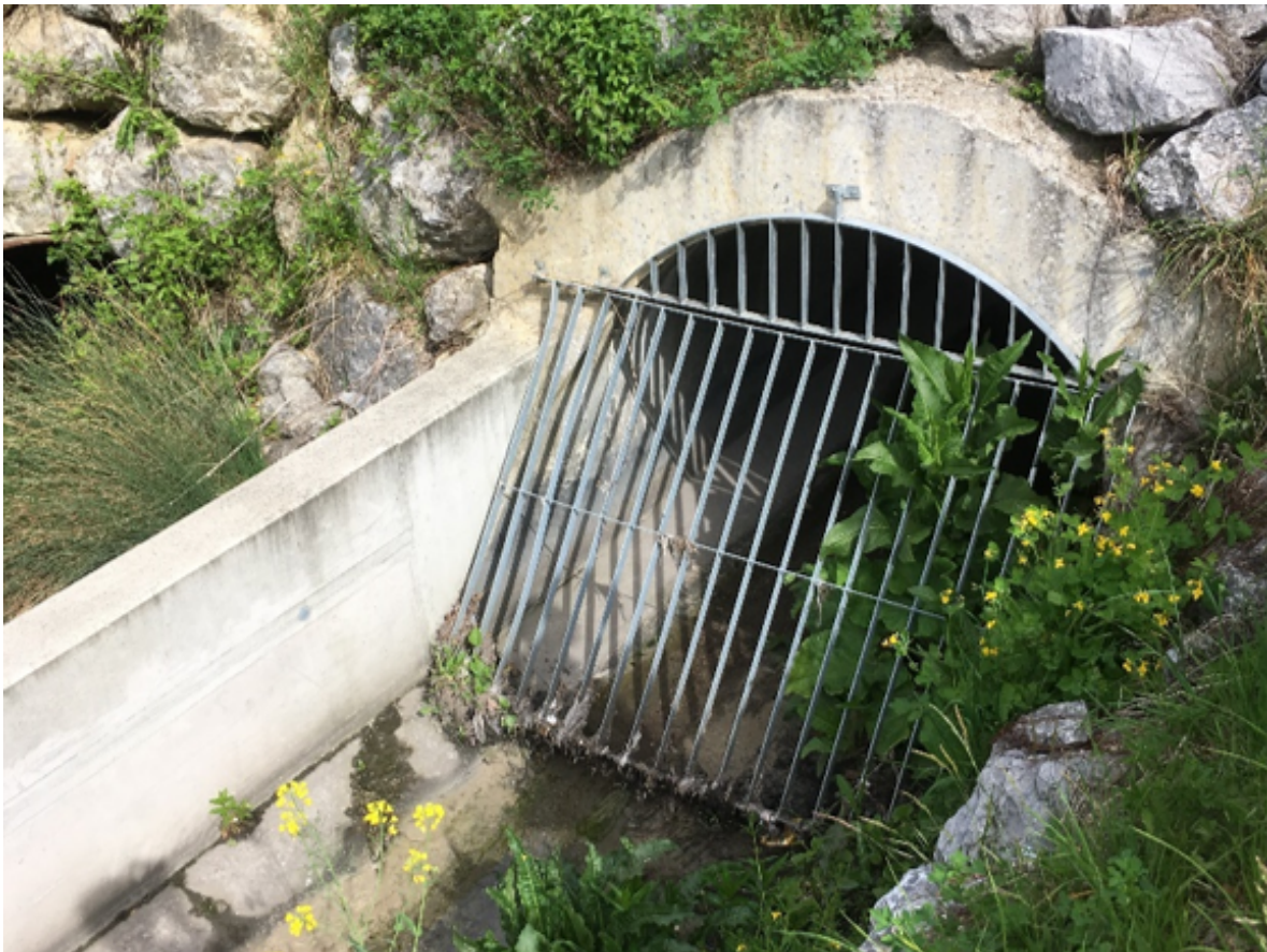
Niederschlagswassereinleitung aus der Trennkanalisation, © Umweltbundesamt/Katharina Lenz.
