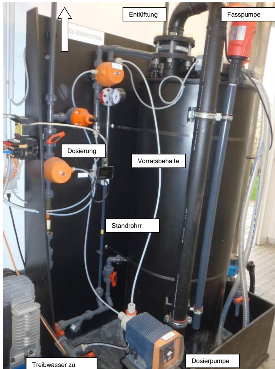
Abbildung 26: H_2O_2 -Dosierstation mit Standrohr zur Überprüfung des Durchflusses.
