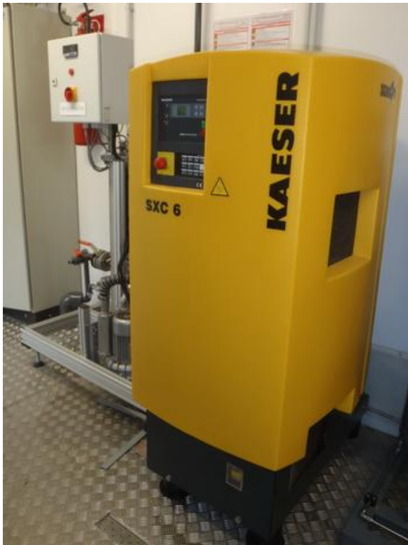
Abbildung 19: Kompressor für Sauerstoffgenerator
