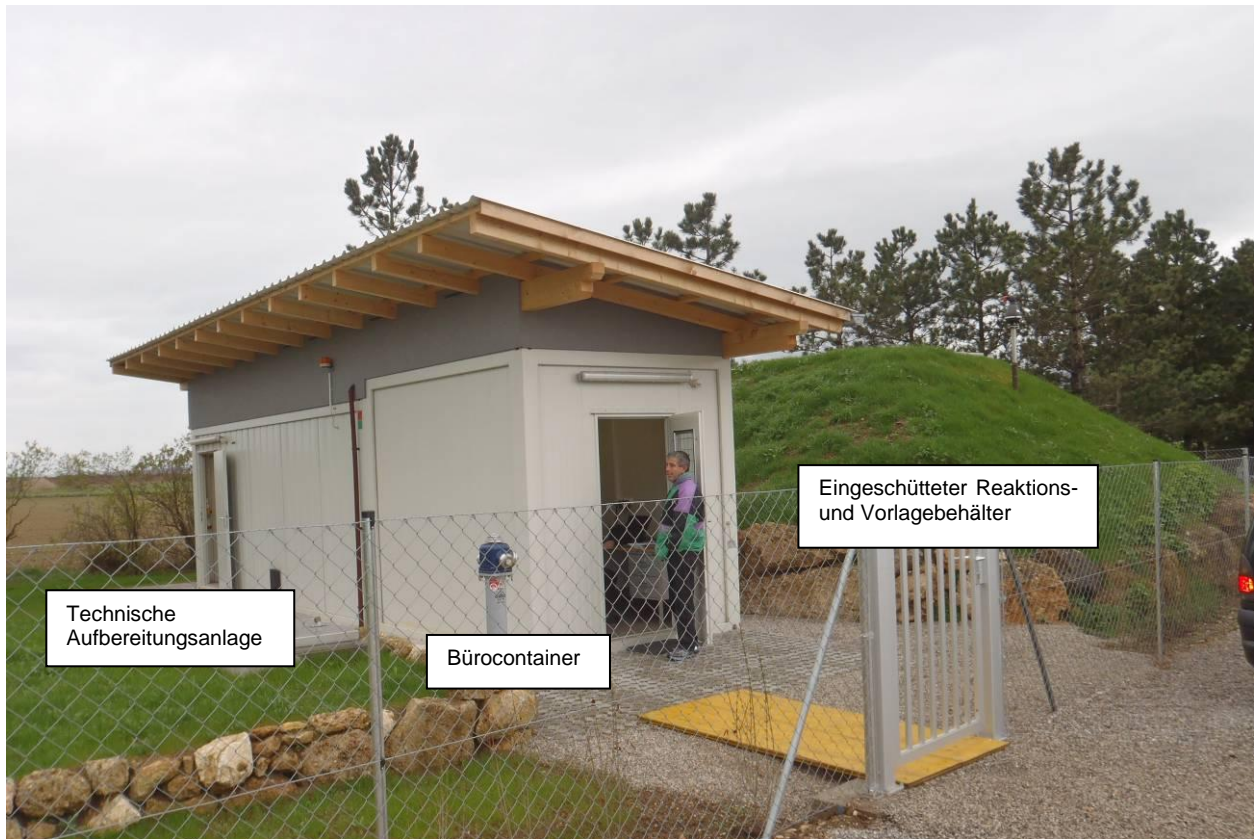
Abbildung 10: Außenansicht Versuchsanlage, Funktionelle Einheiten
