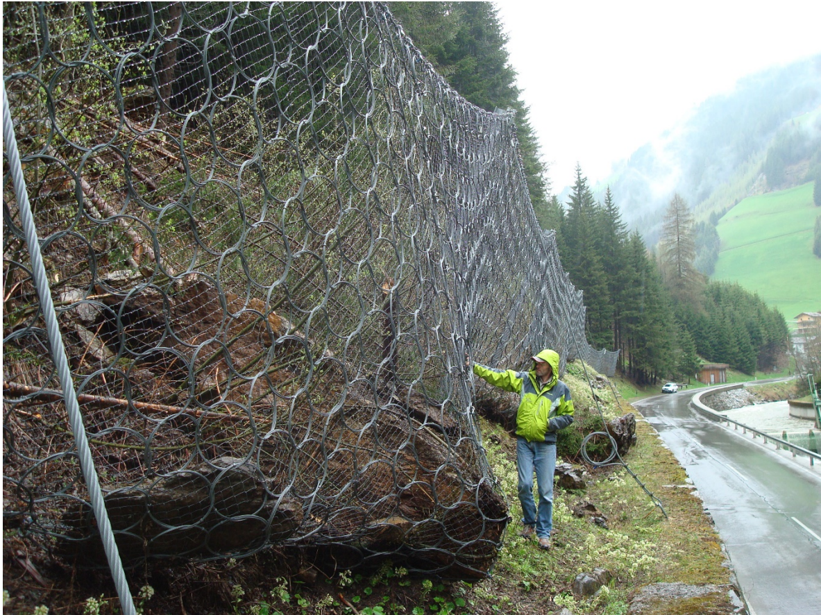
Abbildung 8: Plastisch deformiertes Steinschlagschutznetz
