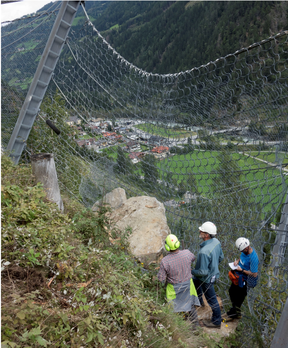
Abbildung 16: Nachkontrolle von Steinschlagschäden in technischen Schutzbauwerken durch Mitarbeiter der Wildbach- und Lawinenverbauung
