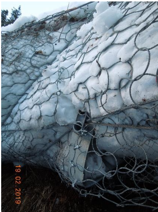
(a) deformierte Stütze
