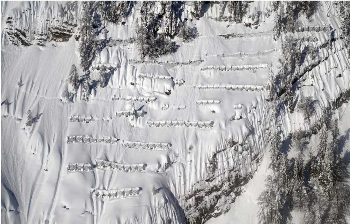
Abbildung 11: Durch Lawineneinwirkungen beschädigte Steinschlagverbauung, Obertraun
