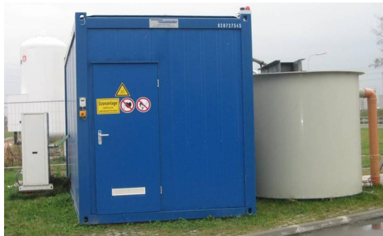
Abbildung 6 Foto der Pilotanlage mit Sauerstofftank, Kühlaggregat, 20' Container und Versuchsreaktor
