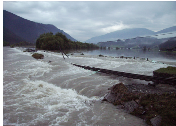
Abb. 14: Dammbürche bei Rettenbach
