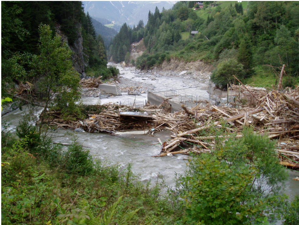
Abbildung 4: Hochwasserschäden Fassung Gfäll
