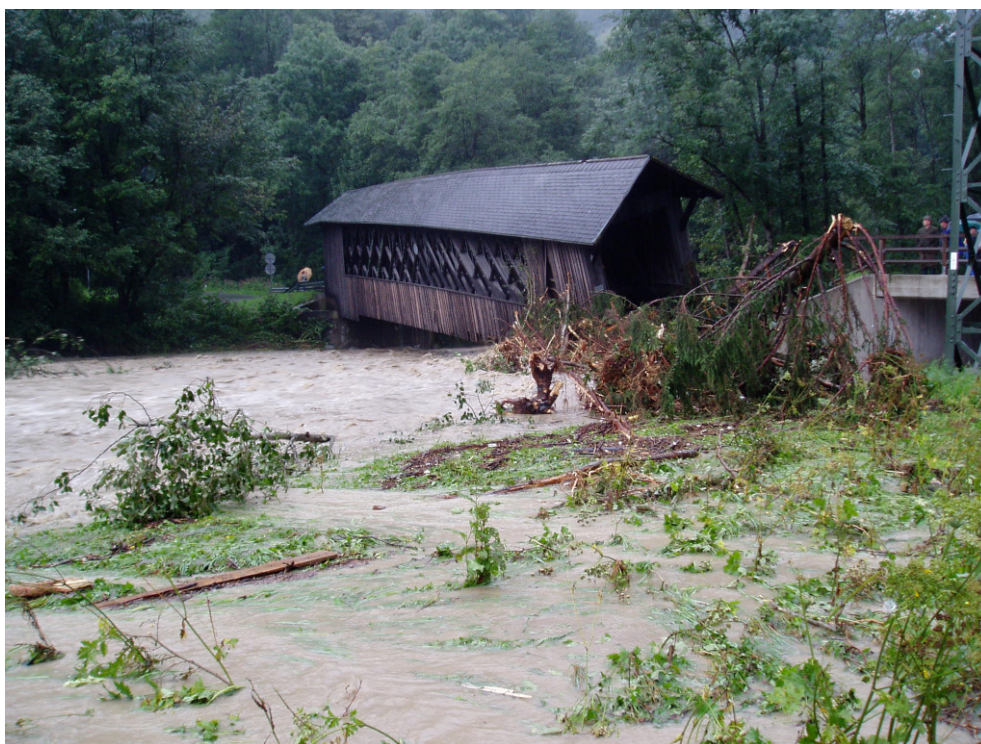
Abbildung 8: Beschädigte Holzbrücke Galgenul
