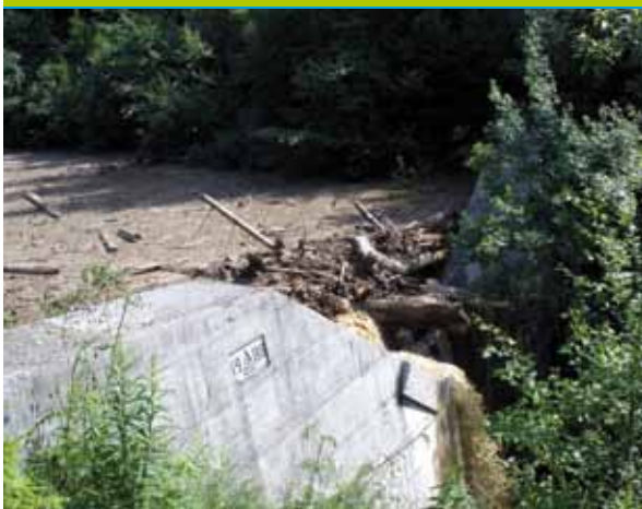
Zurückhaltend - Wildbachsperre bei der Arbeit
