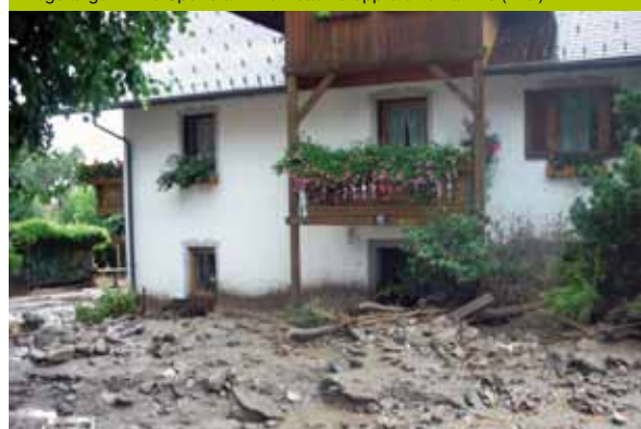
SchlammLawine - Murabgang in Millstatt (Kärnten)
