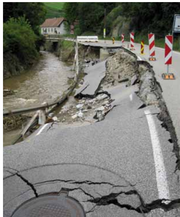
Weggerissen - gefährliche Straßenschäden beim Spitzerbach
