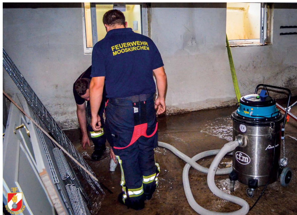
Abbildung 3: Schäden durch Starkregen sind meist materieller Natur. Vor allem schlammhaltiges Wasser in Kellerräumen macht häufig Probleme.
