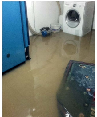
Abbildung 8: Eindringen des Wasser, versetzt mit Schlamm, kann große Schäden an Gebäuden verursachen.
