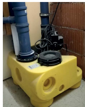
Abbildung 45: Hebeanlage in der Praxis.
