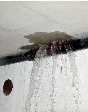
Abbildung 10: Wenn Starkregenfälle das Kanalsystem überlasten, können Schwachstellen im System oder fehlende Rückstausicherungen zu ernststen Schäden führen.
