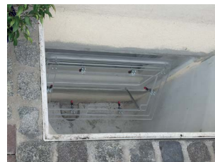
Abbildung 58: Wasserdicht verschließbares Kellerfenster.
