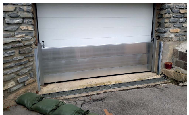
Abbildung 37: Mobiles Dammbalkensystem am Garagentor.
