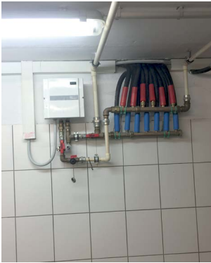
Abbildung 53: In potenziell überfluteten Bereichen sollten die Installationen möglichst hoch über dem Fußboden angebracht werden. Als Wandverkleidung haben sich Fliesen bewährt.
